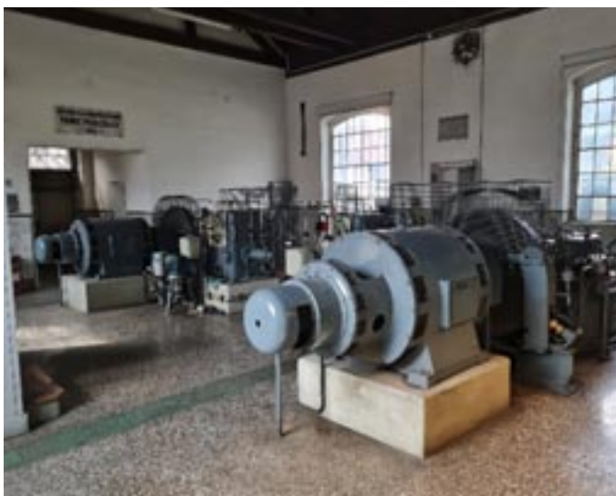
Foto: E-Werk Kindberg, Generatoren im Kraftwerk
